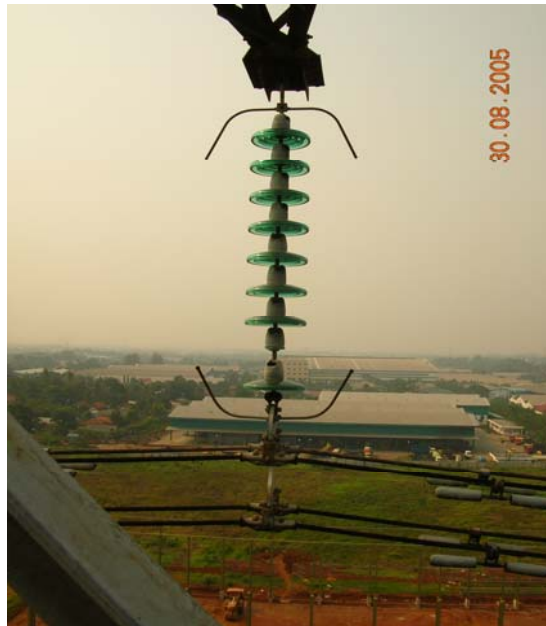
Gambar 10. 3 Kerusakan pada isolator gantung
