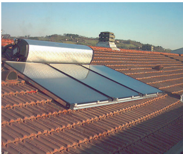
Pannello solare termico su tetto.
