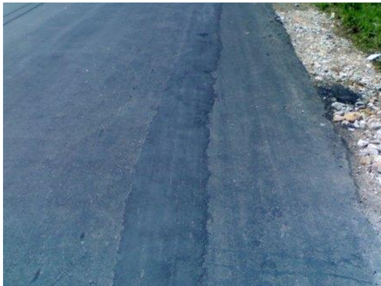
Gambar 4. Hasil tambal sulam jalan raya
