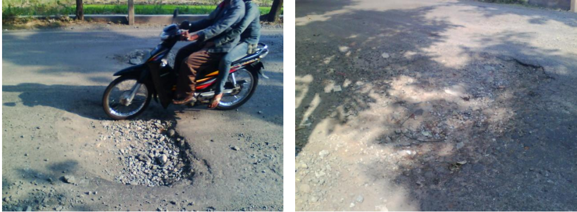
Gambar 2. Kondisi jalan raya yang berlubang
