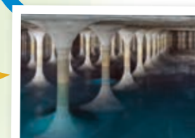
6 Hochbehälter Forstenrieder Park
