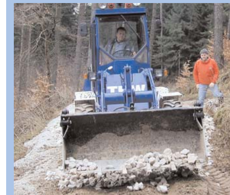
Mit dem Radlader des THW-Ortsverbandes Lauf verteilt Peter Gstader Schotter auf den morastigen Waldwegen. Ansonsten wären die Bergungsfahrzeuge nicht bis zur Absturzstelle gekommen.
