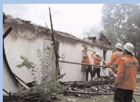
Mit Einreißhaken ziehen Feuerwehrleute angekohlte Balken vom Dachbereich. Der Dachstuhl ist bereits zusammengebrochen. Im Hintergrund löschen zwei Kameraden mit einem C-Rohr durch eine Fensteröffnung.
